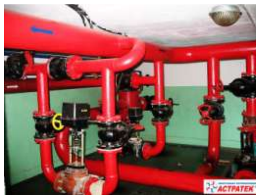
Объект: Разводка в тепловом пункте, трубопроводы подачи и обратки теплоносителя, ОАО «Механизированная колонна №1», г. Ухта, Республика Коми (2008 г.) Эффективность: После изоляции АСТРАТЕК обеспечена требуемая температура.
