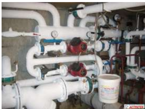
Объект: Тепловой узел, г. Омск (2009 г.) Эффективность: После изоляции АСТРАТЕК уменьшены теплопотери, снижена травмоопасность.
