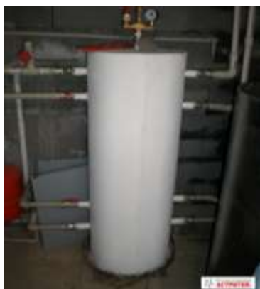
Объект: Буферный бак отопления в частном доме, г. Алматы, Республика Казахстан (2009 г.) Эффективность: После изоляции АСТРАТЕК уменьшены теплопотери, снижена травмоопасность.
