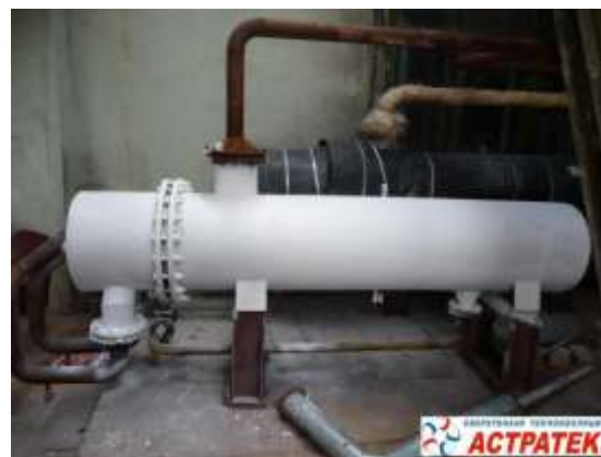
Объект: Емкость для горячей воды, г. Новороссийск, Краснодарский край (2010 г.) Эффективность: После изоляции АСТРАТЕК температура поверхности объекта снижена до нормативных значений, снижены теплопотери.
